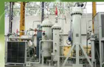
Planta de Tratamiento de Gas (1.5 millones pie 3 /día)
